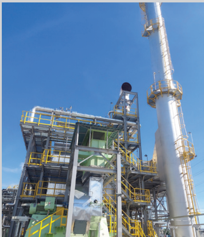
バイオマスボイラー
